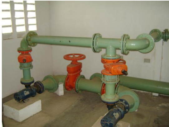
Figura 11 – Bombas de recalque Fonte: Própria, 2010.
