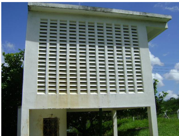
Figura 7 – Captação/Fazenda Canafísula. Fonte: Própria, 2010
