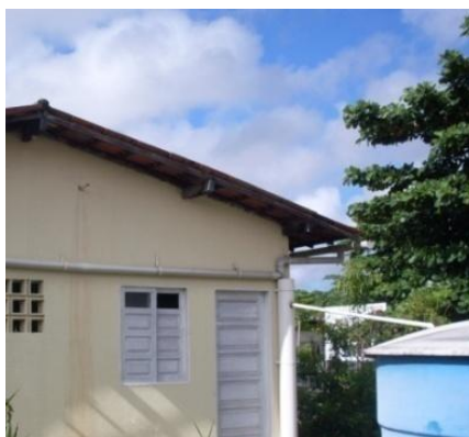
FIGURA 1: Estrutura de captação e transporte da água de chuva.
