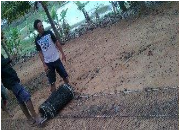
Figura 16: Preparação da rede com cordas, para ser presa nas laterais da barragem.
