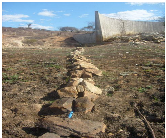
Figura 45: Tomada d'água clandestina dentro da barragem, utilizada para irrigação.
