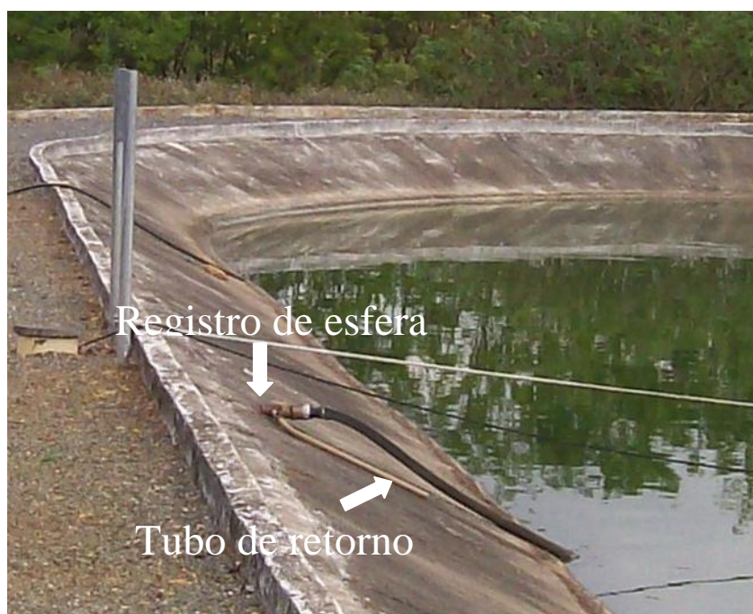
Figura 6 Tubo de retorno da linha principal de bombeamento.
