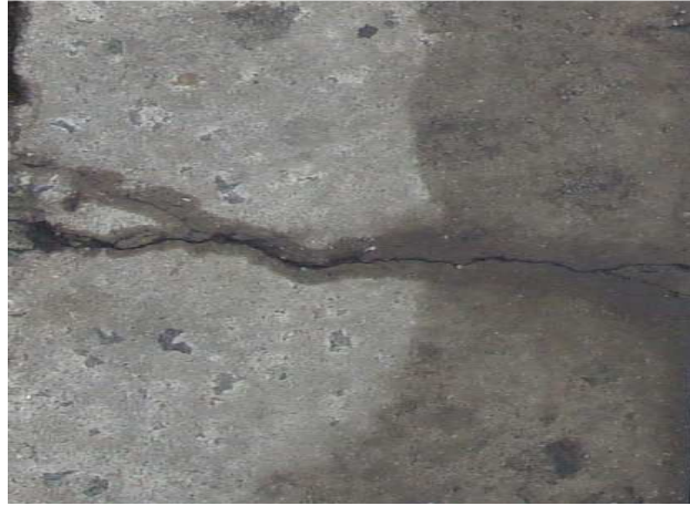
Figura 6 - Piso com leves rachaduras.
