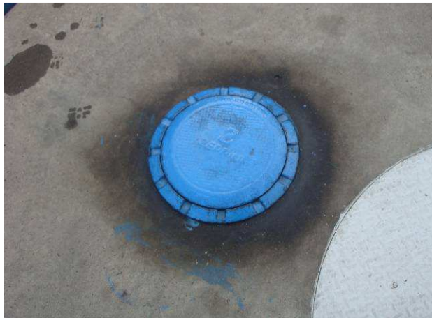
Figura 9 - Sinais de derramamento de diesel ao redor da câmara de descarga selada.
