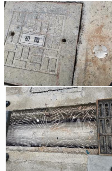
管网明管化和标识化
