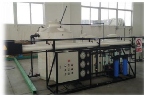
高压反渗透系统 High pressure RO system
