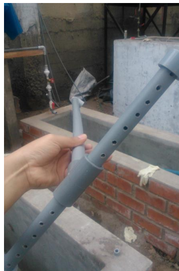
Figura 02.- Holes in Pipe
