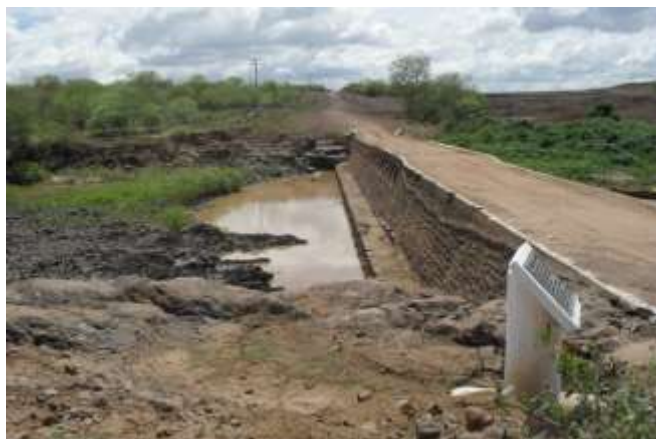
Figura 6 – Condições da passagem molhada do Taquara. Fonte: Própria.
