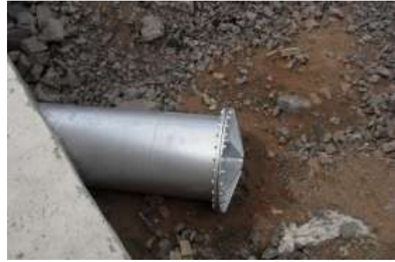
Figura 8 – Detalhe da tubulação. Fonte: Própria.
